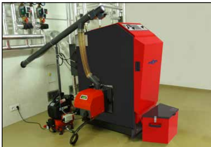
Příklad kotelny s kotlem D50P
