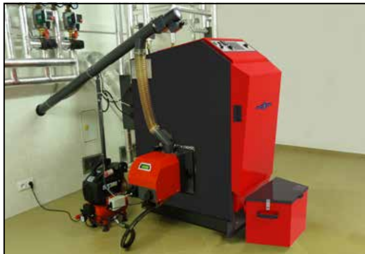
Příklad kotelny s kotlem D50P
