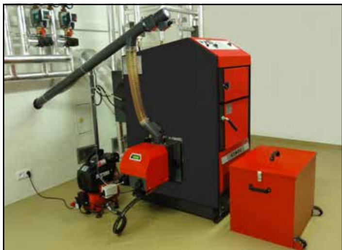
Příklad kotelny s kotlem D50P
