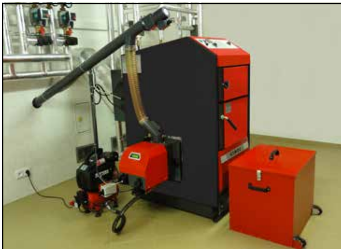
Příklad kotelny s kotlem D50P
