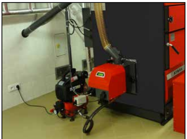
Anordnung des Verdichters neben dem Kessel
