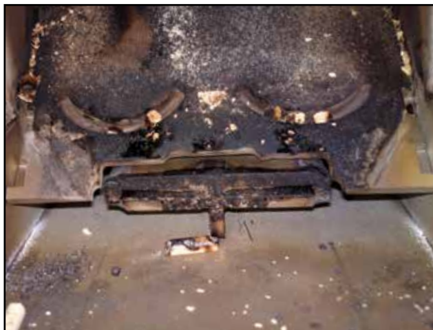
Ukázka lehkého zanesení po 4 měsících provozu
