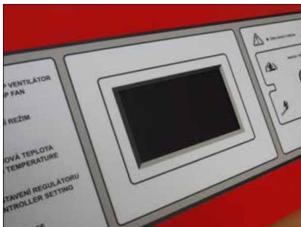
Regulator w panelu przyrządowym kotła
