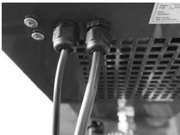
Rys. 11 - przyłączenie elektrozaworu i sprężarki pneumatycznego czyszczenia palnika
