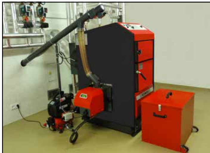
Příklad kotelny s kotlem D50P
