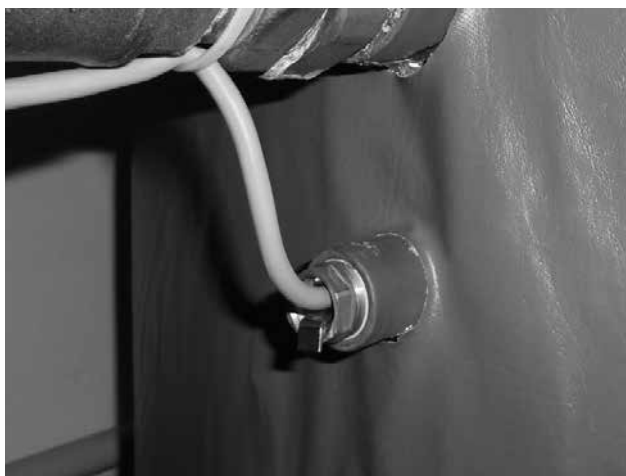
Obr. 14 - pohled na čidlo teploty vody v jímce akumulční nádrže (TV a TS)
