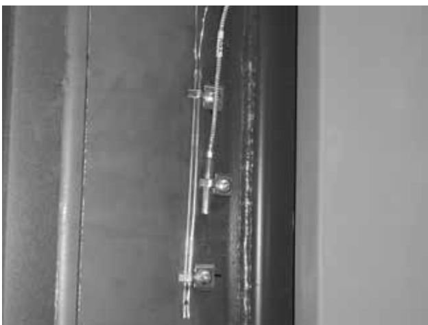
Obr. 15 - pohled na čidlo teploty spalin TSV na boku kouřového kanálu kotle DCxxGSP
