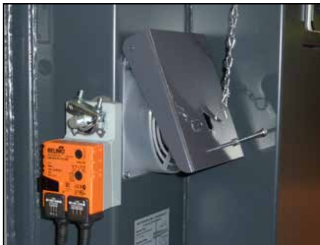
Přívod spalovacího vzduchu u kotle DCxxGSP uzavřen automaticky pomocí servopohonu Belimo
