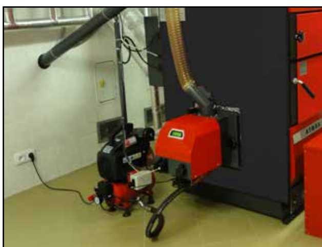
Ukázka postavení kompresoru vedle kotle
