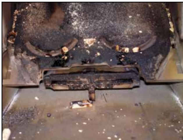
Ukázka lehkého zanesení po 4 měsících provozu
