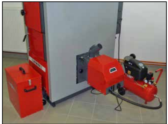
Anordnung des Verdichters neben dem Kessel
